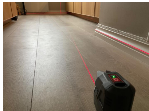
Nivellering kjøkken, avvik, ca. 15-30 mm
