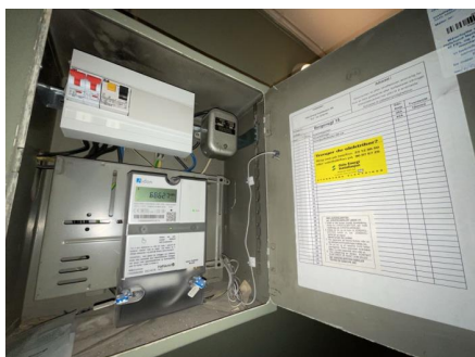
El.skap i fellesgang.
