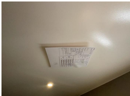
Test med løst ark viste tilfredstillende avtrekk.
