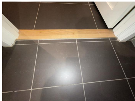
Overgang ved dørterskel.
