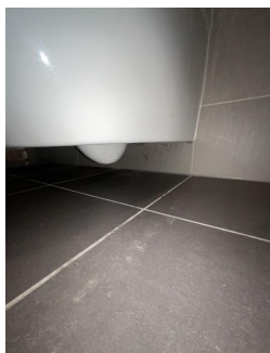
Ikke mulig å konstatere hvilken lekkasjesikring type som er valgt.
