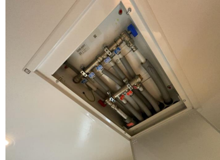
Fordelerskap på bad.
