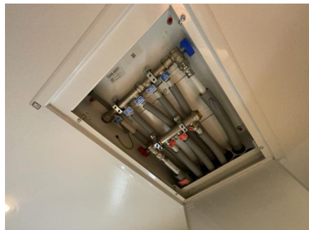
Fordelerskap på bad.
