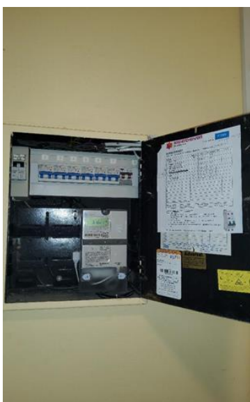
Elektrisk anlegg - [Sikringskap]
