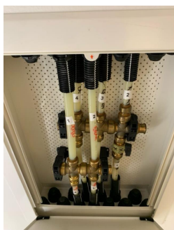
Rørfordelerskap skap plassert i tak på baderom.
