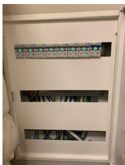
Sikringskap plassert i skap i gangen.
