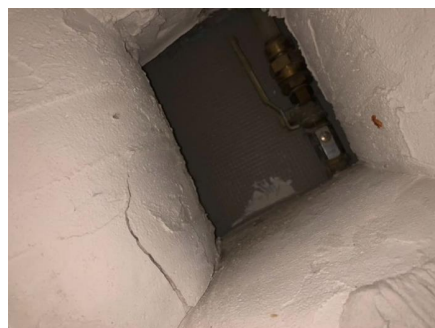
Stoppekran plassert i nederste skuff i kjøkkenskap mot baderom.
