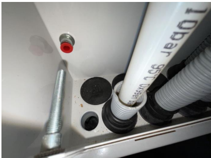
Avrenningshull i fordelerskapet.
