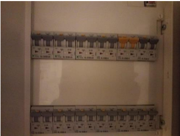
Elektrisk anlegg - [Sikringskap. ]
