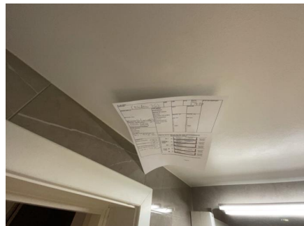
Test med løst ark viste tilfredstillende avtrekk.
