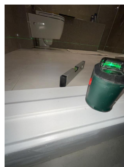
Fallforhold målt i retning sluk med krysslaser.
