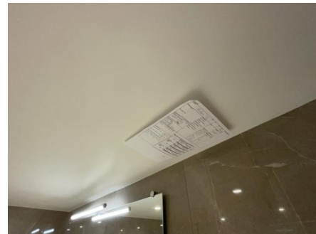
Test med løst ark viste tilfredstillende avtrekk.
