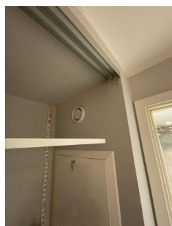
Avtrekksventil over vaskemaskinen.
