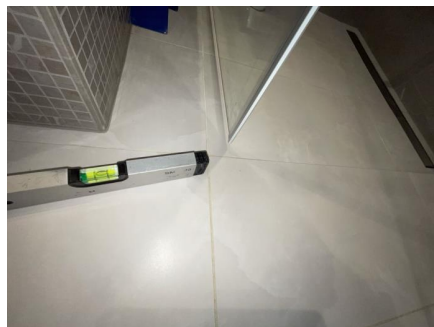
Fallforhold målt i retning sluk. Svakt motfall.
