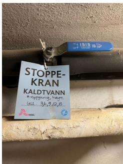
Felles hovedstoppekran for vannledning i oppgang A. Plassert i kjeller.
