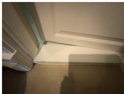
Luftespalte må gjøres større.
