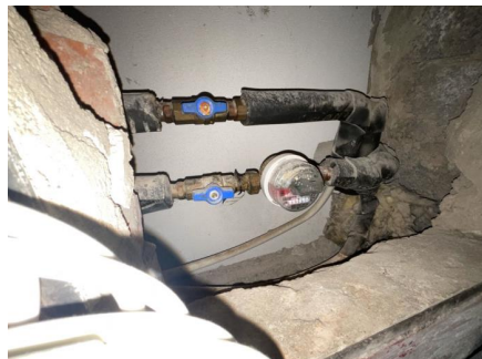
2 stk. stoppekraner ble testet og fungerte 100%.
