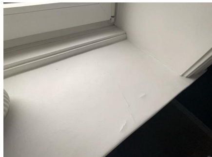
Noe avskalling i vinduspost.
