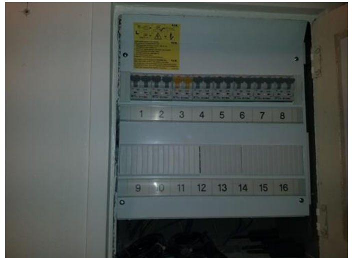
Elektrisk anlegg - [Sikringskap.]
