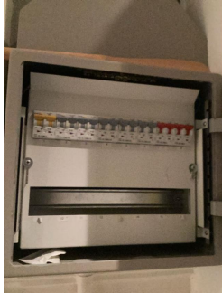
Sikringskapp med automatsikringer plassert i entre/gang.
