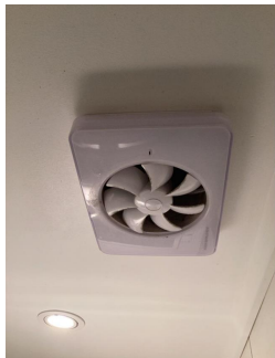
Elektrisk avtrekksvifte på bad/vaskerom.
