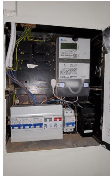
Elektrisk anlegg - [Sikringsskap ]
