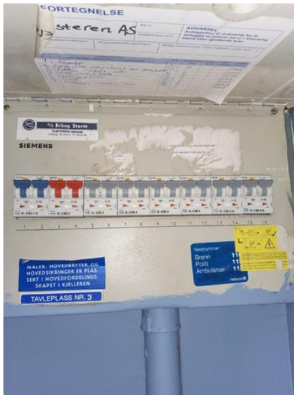
Elektrisk anlegg - [Sikringskap ]
