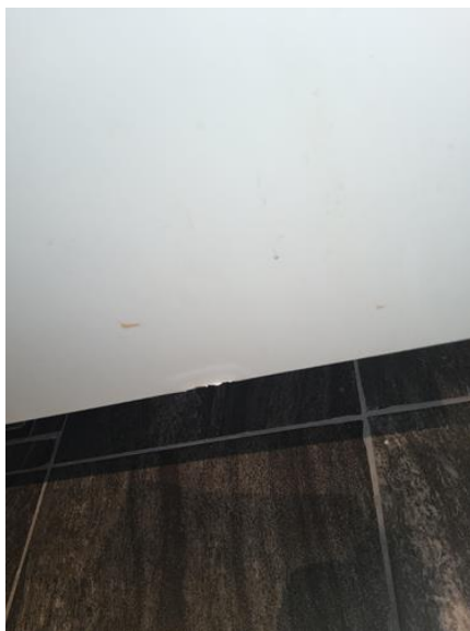
Sanitærutstyr / innredning - [Fuktskade på servantskap. ]
