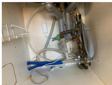
Røropplegget i kjøkken
