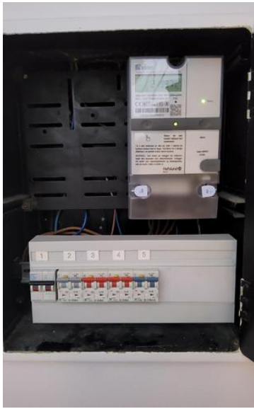
Elektrisk anlegg - [Sikringskap]
