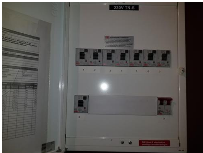
Elektrisk anlegg - [Sikringskap. ]
