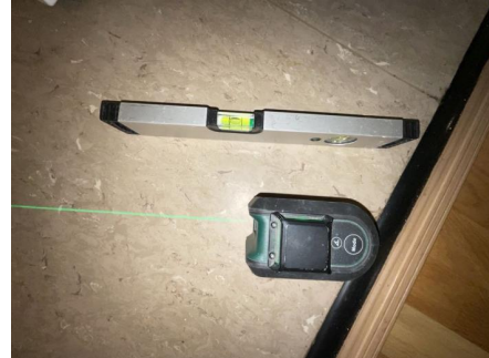
Svakt motfall målt i retning sluk.
