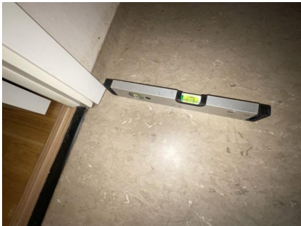
Svakt motfall målt i retning sluk.
