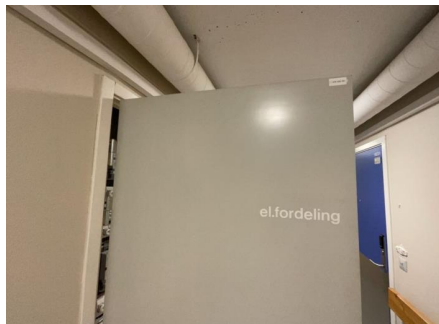
Dør til felles el.skap.
