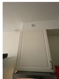
Ventilator. Utkast i ventilen over overskapet.
