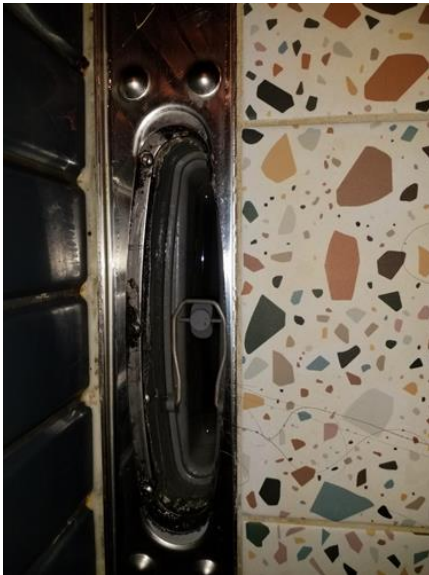
Kommentar - [Sluk bad, 1.etasje ]
