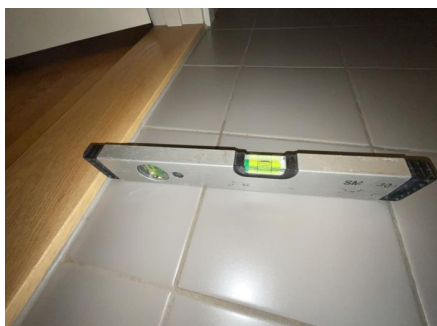
Svakt motfall ved dørterskel i retning sluk.
