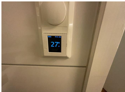
Termostadbryter for varmekabler.
