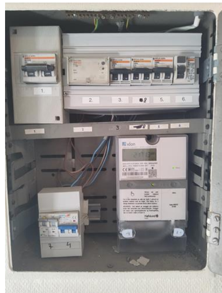
Elektrisk anlegg - [Sikringsskap ]
