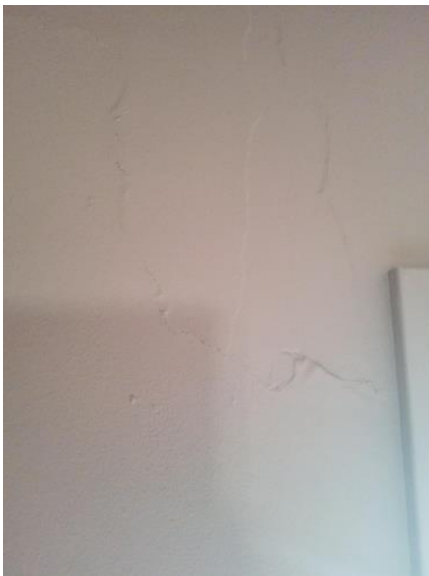
Overflater vegger - [Riss på yttervegg ved vindu på soverom. ]
