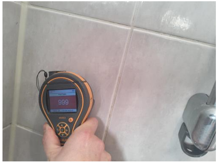
Fukt i tiliggende konstruksjoner - [Fuktsøk ved dusjonen ]
