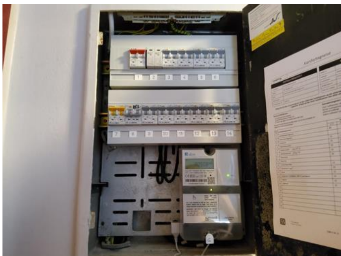
Elektrisk anlegg - [Sikringskap]
