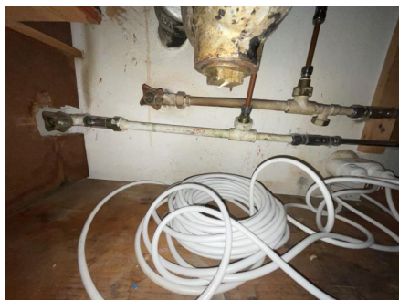
Originale vannrør. Nyere kuleventiler.
