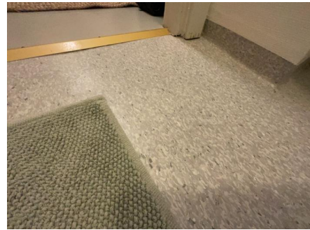
Overgang ved dørterskel.
