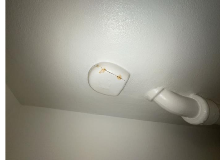
Synlig sprekk og rust i slukkopp.
