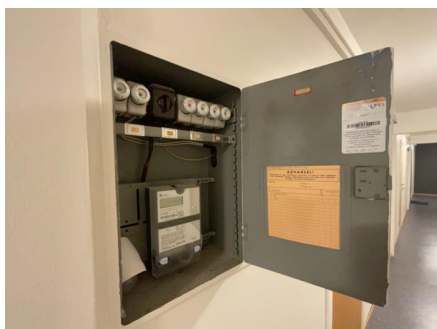
El.skap med gamle sikringer.
