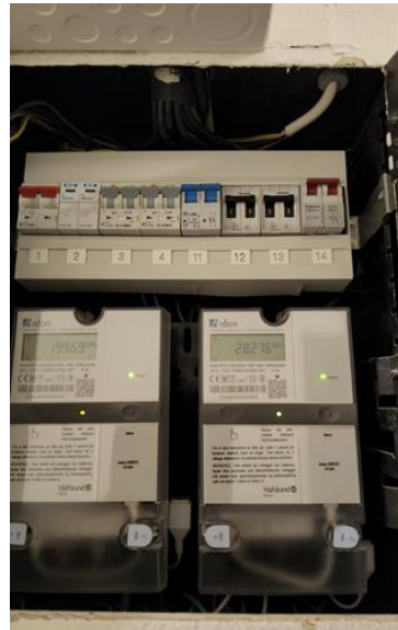
Elektrisk anlegg - [Sikringskap]
