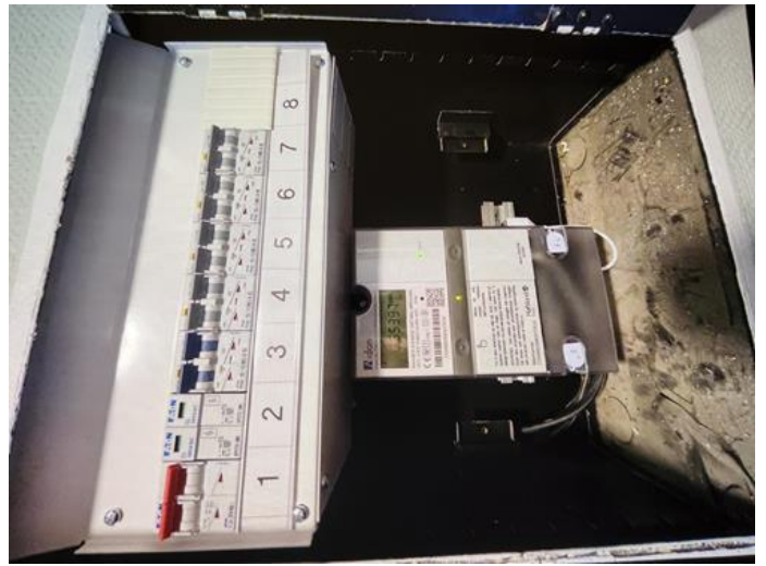
Elektrisk anlegg - [Sikringskap]
