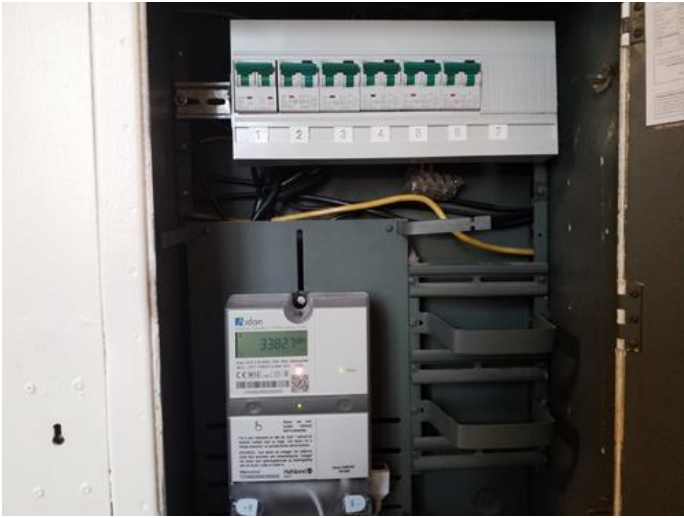
Elektrisk anlegg - [Sikringskap. ]
