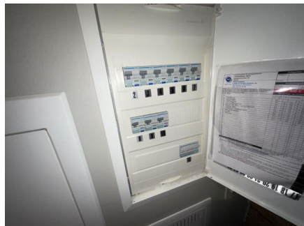
Fordelerskap med jordfeilautomater.
