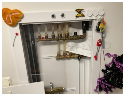
Fordelerskap i gang utenfor bad/vaskerom
