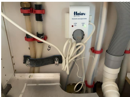
Under kjøkkenbenk. Synlig vannrør og automatisk vannstoppersystem.
