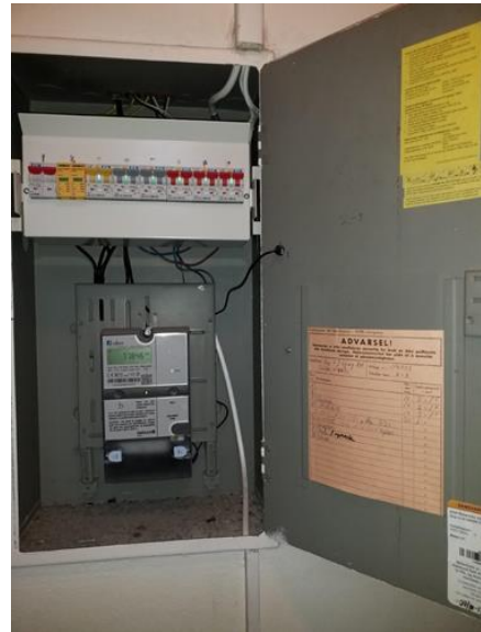
Elektrisk anlegg - [Sikringskap ]
