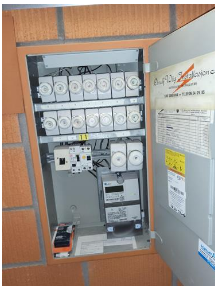
Elektrisk anlegg - [Sikringsskap]
