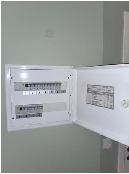
Elektrisk anlegg - [Sikringskap ]
