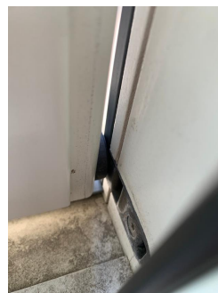
Enkelte vinduer kniper mot karm
