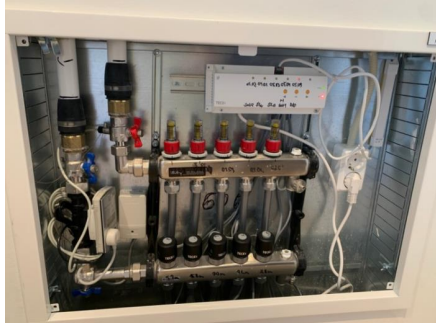
Rørskap for varme
