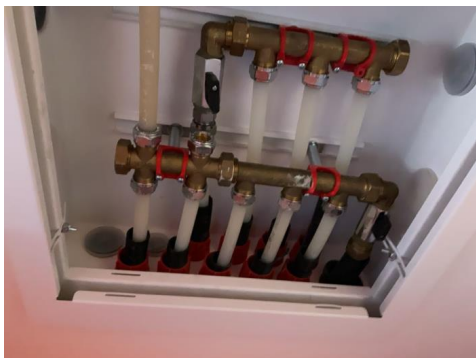
Fordelerskap i bad. Med hovedstoppekraner.
