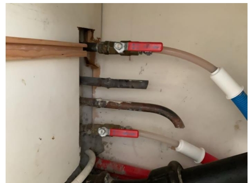
Hovedstoppekraner i kjøkkenskap.
