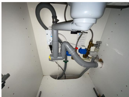
Rør på kjøkken. Lekkasjestopper.
