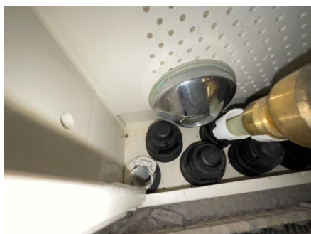
Avrenningshull i fordelerskapet.
