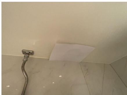
Test med løst ark viste tilfredstillende avtrekk.
