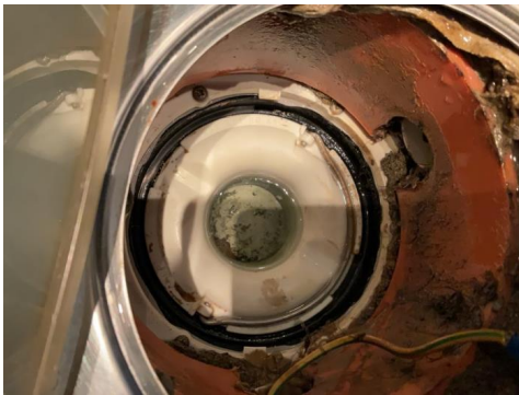
Sluk i dusjsonen.
