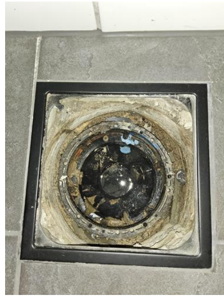
Membran, tettesjikt og overgang til sluk. - [Sluk baderom under servantskap]
