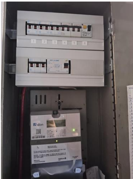
Elektrisk anlegg - [Sikringskap]
