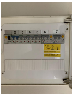
Sikringsskap plassert i entre/gang.
