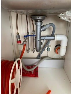
Avløpsrør i underskap vask på kjøkkenet.
