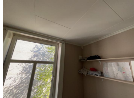
Lufteluke i yttervegg.
