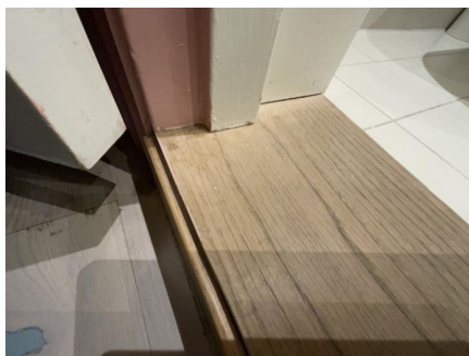
Luftespalte under dørbladet.
