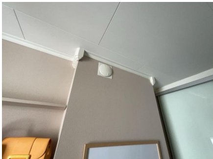
Lufteluke i sjakt/kanal.
