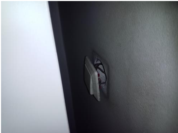
Kommentar - [Løs veggbryter i entré. ]
