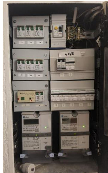
Elektrisk anlegg - [Sikringsskap ]
