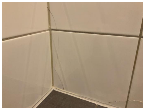
Synlig sprekk fliser.
