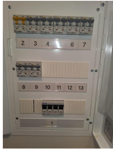
Elektrisk anlegg - [Sikringskap]
