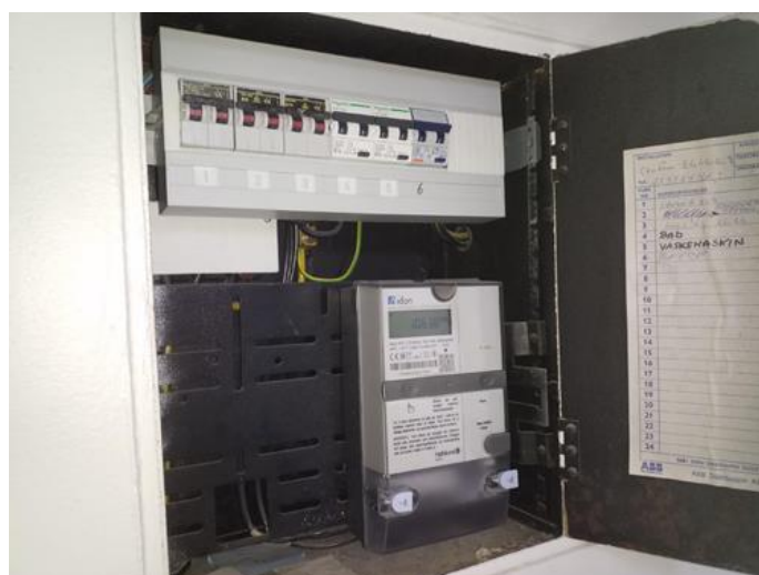
Forenklet vurdering av det elektriske anlegget - [Sikringskap.]
