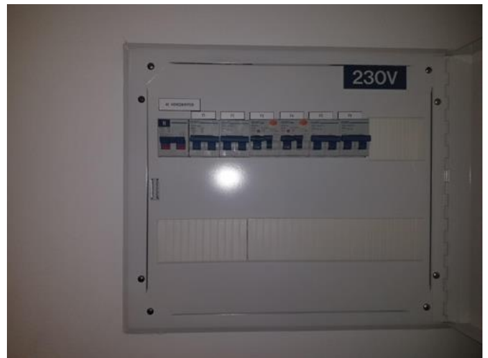
Elektrisk anlegg - [Sikringsskap.]
