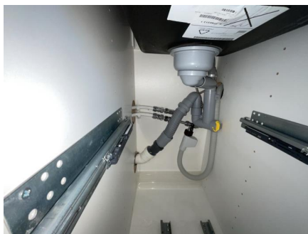
Rørøpplegg på kjøkken.
