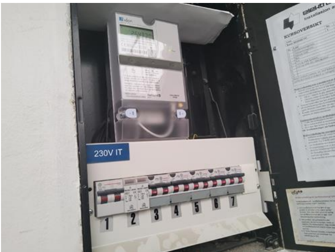
Elektrisk anlegg - [Sikringskap]
