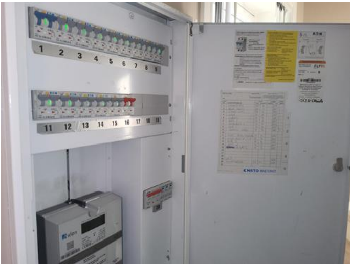
Beskrivelse - [Sikringskap med kursfortegnelse.]
