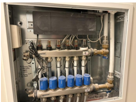
Rørfordelerskap vannbåren varme i vegg på teknisk rom.
