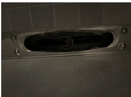
Langsluk plassert i dusjsonen
