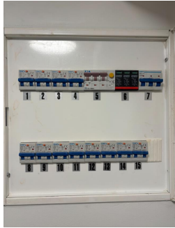
Sikringskapp plassert i vegg på teknisk rom
