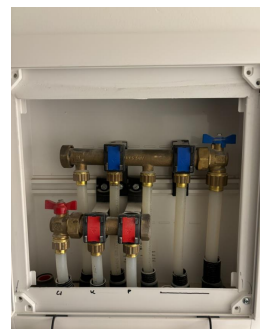
Rørfordelerskap plassert i vegg på teknisk rom.
