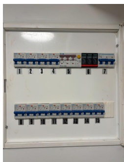
Sikringskapp plassert i vegg på teknisk rom
