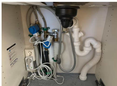
Avløpsrør i underskap vask på kjøkkenet.
