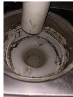
Sluk plassert under innebygd badekar
