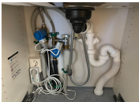
Avløpsrør i underskap vask på kjøkkenet.
