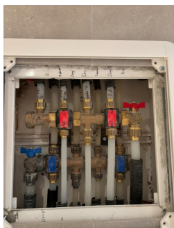
Rørfordelerskap plassert i vegg på badrom i kjelleren.
