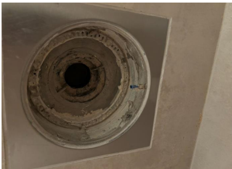
Baderomssluk plassert under servantskap.
