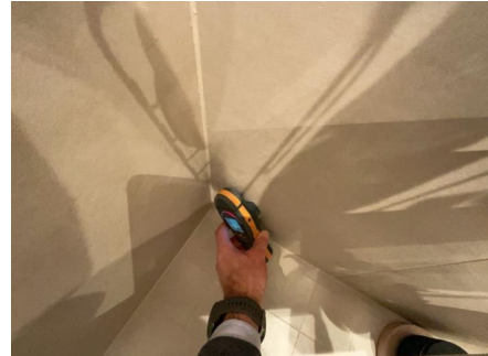
Protimeter fuktapparat gjorde utslag langs sokkel.
