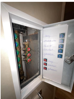
Samlestokk (rørkoblinger) bak inspeksjonsluke på badrom.
