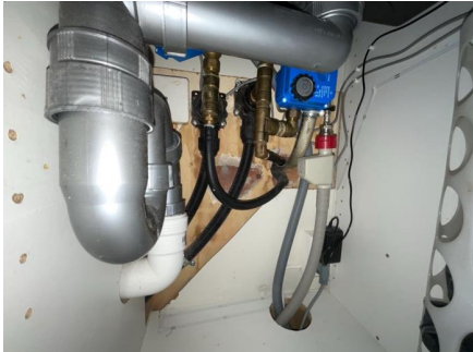
Rør på kjøkken. Lekkasjestopper.
