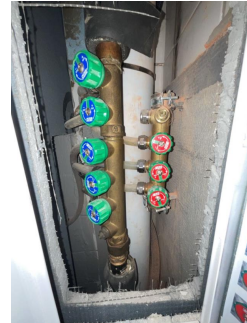
Samlestokk. Avløpsrør i bakkant.
